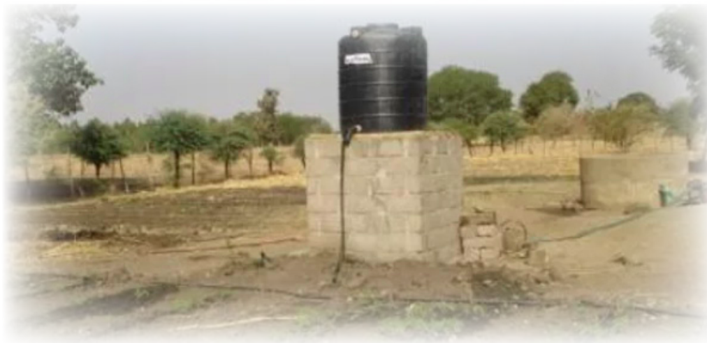
Un exemple d'équipement de Conservation des Eaux : Une installation d'irrigation au goutte-à-goutte
